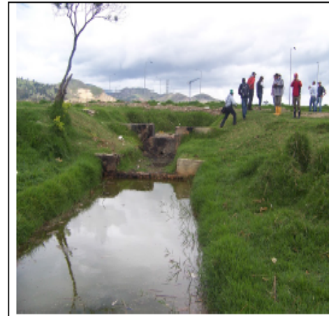
Fotografía 19. Estructura de entrada existente en el sector La María, Quebrada Tibanica, que será adecuada para la construcción de un biofiltro.
